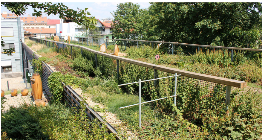
Zelená střecha budovu izoluje a zároveň zadržuje vodu.
